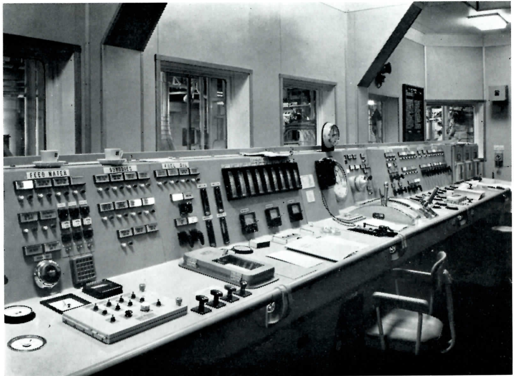
Het bedieningspaneel in de controlekamer, die zich op het boventussendek aan bakboord in de machinekamer bevindt.
